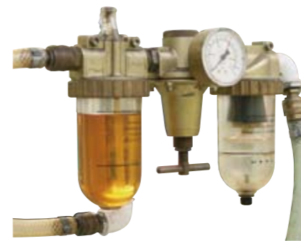
Рис. 4: «Пожиратель энергии» – децентрализованный редуктор давления с водоотделителем
